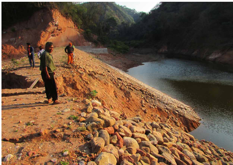
Foto 7. Daños en la represa de Timboycito
